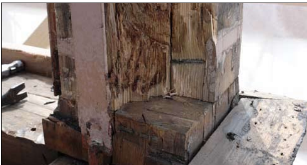
Uusittu eteläkulman pilari, joka oli kasattu liimapuumenetelmällä, oli lahonnut sisäosiltaankin. Alkuperäinen tyvi oli kuitenkin ehyt.
