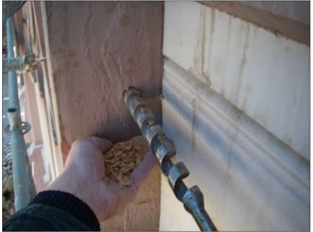
Vesikatolta pilasterin päähän vuotanut vesi oli aiheuttanut pientä lahoamista. Korjaukseen riitti pienehkö puupaikkaus.
