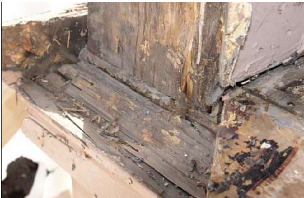
Pohjoiskulman pilari oli jo kertaalleen vaihdettu. Liitokseen oli pantu kaksikomponenttimassaa.
